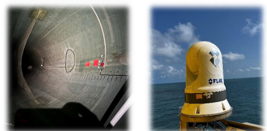
撞擊偵測系統及熱影像儀安裝情況
