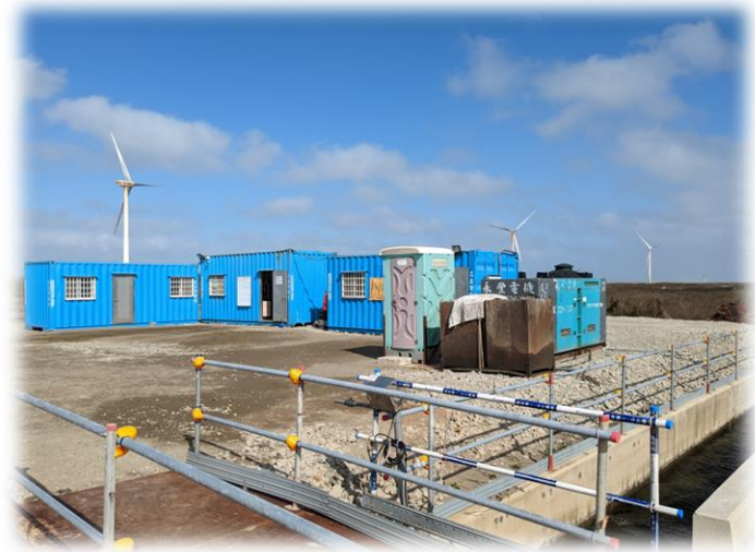
▲ 陸域自設(升)降壓站工區現況
