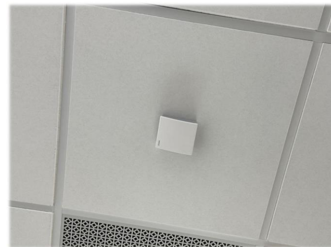
設置IAQ監測器並定期檢測
