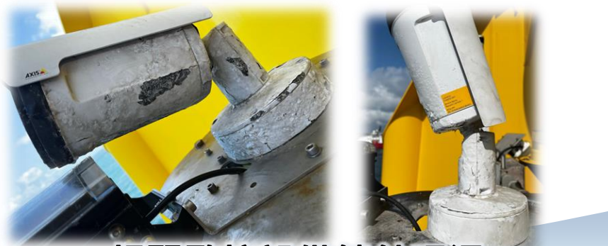
相關監控設備鏽蝕現況
