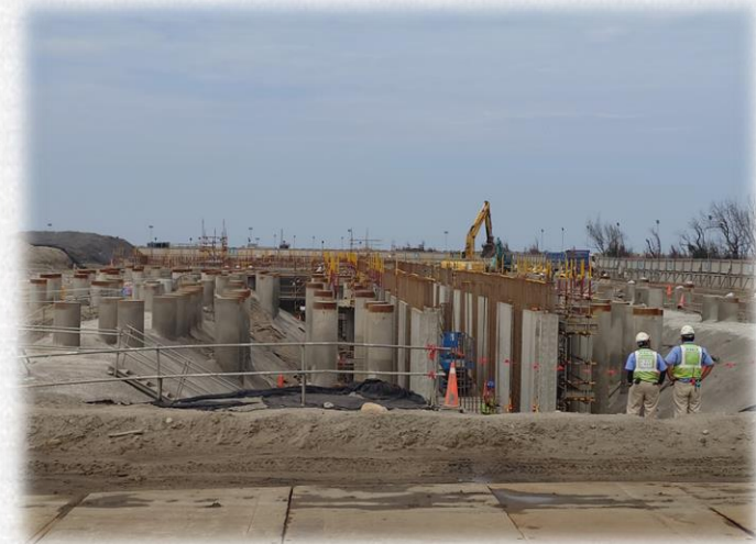
▲ 陸域自設(升)降壓站工區現況
